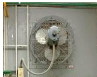
Figura 7 Extractor de laboratorio. Elaboración propia.
